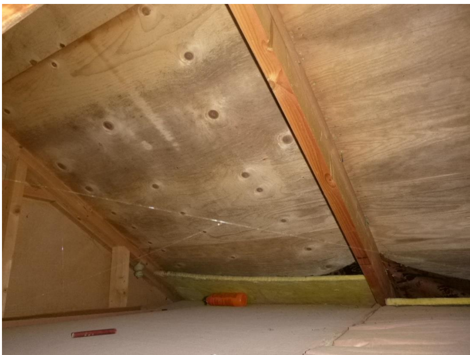
7. Mikrobiell påväxt (Generell bild)
